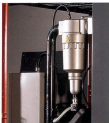
Separatore di condensa Scaricatore elettronico di condensa Condensate drain Condensate drain solenoid valve
